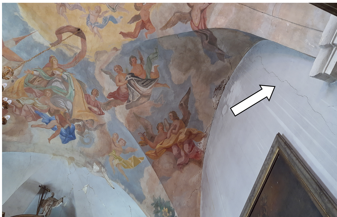
Zdjęcie nr 4. Strzałka wskazuje pęknięcie pionowe ściany.
