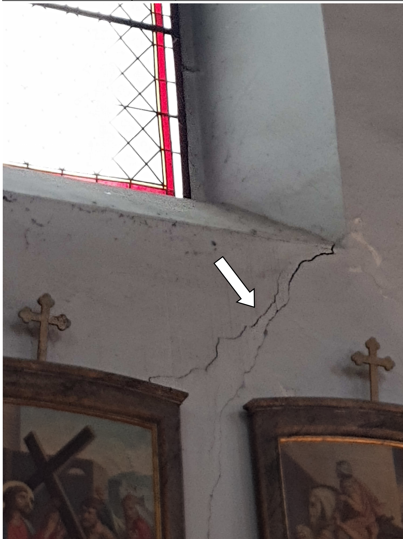
Zdjęcie nr 6. Strzałka wskazuje pęknięcie ścian w obrębie okien.
