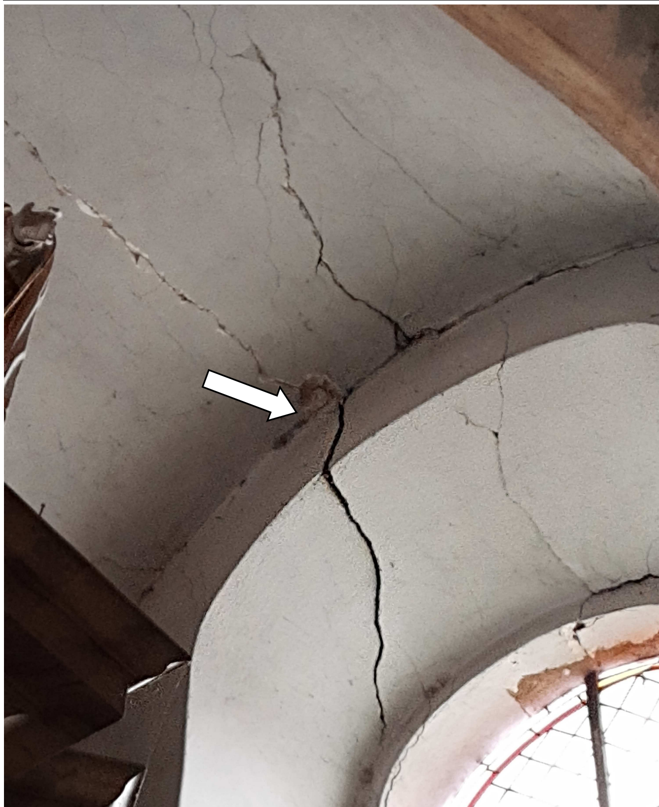
Zdjęcie nr 5. Strzałka wskazuje pęknięcie łuku nadokiennego.
