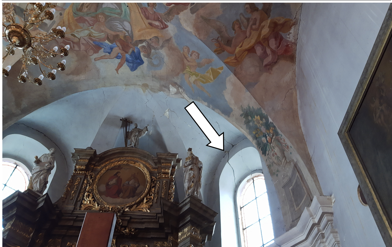
Zdjęcie nr 3. Strzałka wskazuje pęknięcie łuku nadokiennego.
