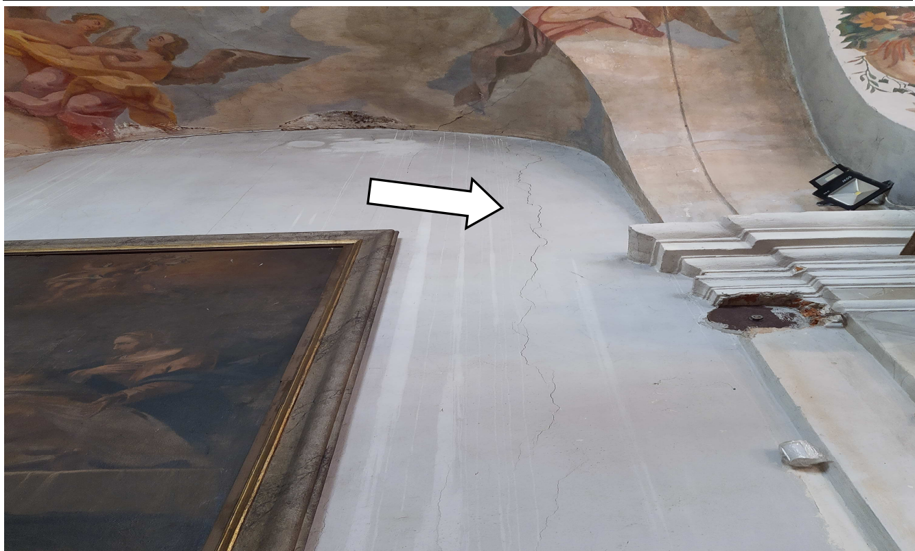
Zdjęcie nr 1. Strzałka wskazuje pionowe pęknięcie
